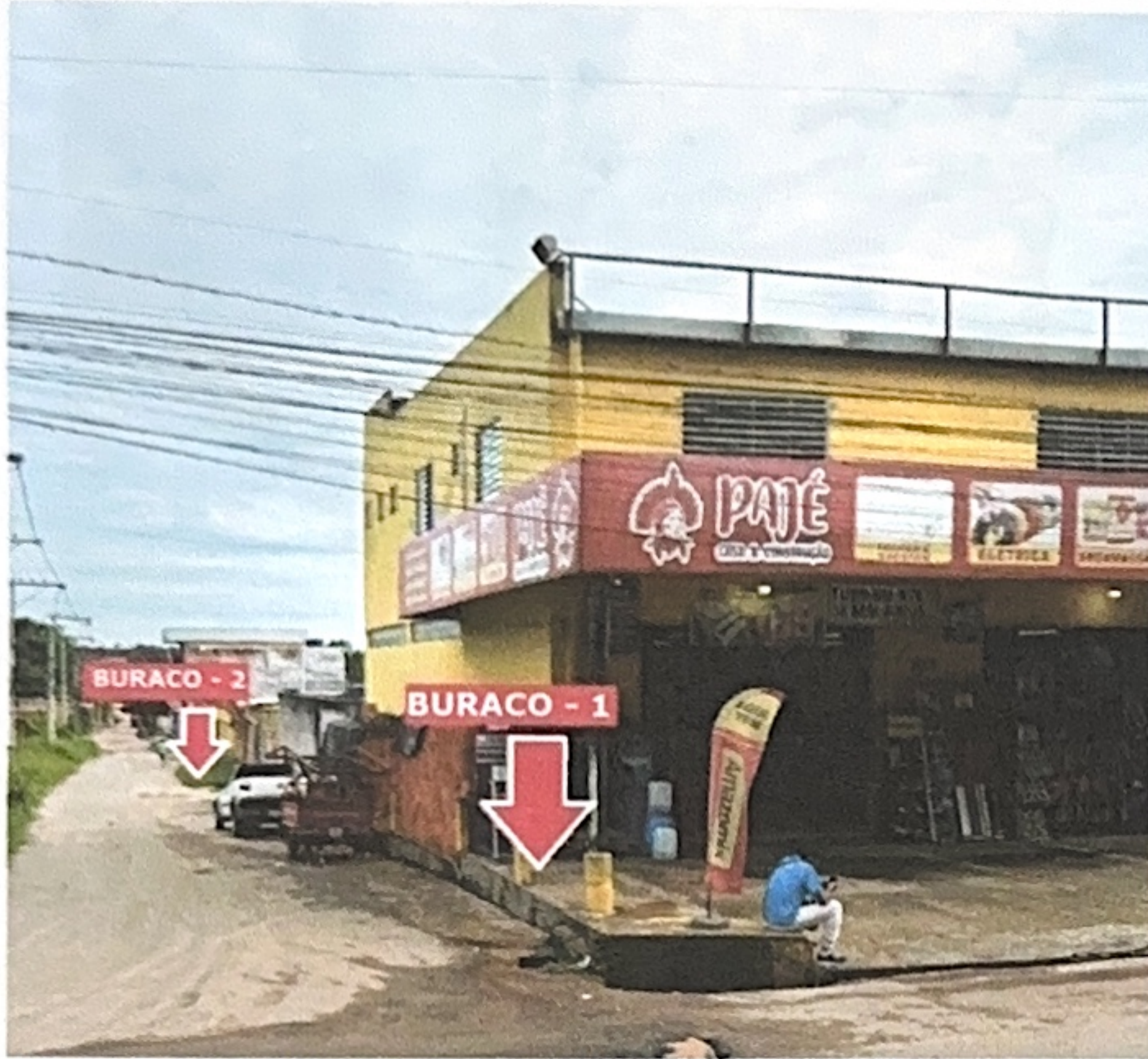
Figura 2: Rua Uniflor, Comunidade Nações Indígenas, Bairro Tarumã: local onde se encontram os buracos.
